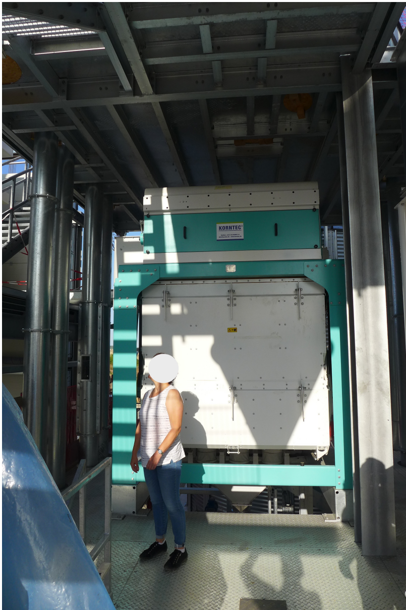
Bild 5: Siebreinigung mit Aspiration (montagebereit), Rupp Landhandel GmbH, Foto: Thorsten Neubauer
